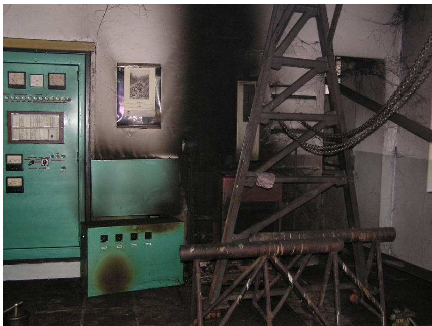
Obr. 15: Kompenzační rozvaděč po požáru (zdroj: fotodokumentace majitele)
