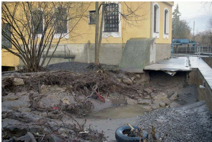
Obr. 14: Vymletý prostor za elektrárnou (zdroj: fotodokumentace majitele)
