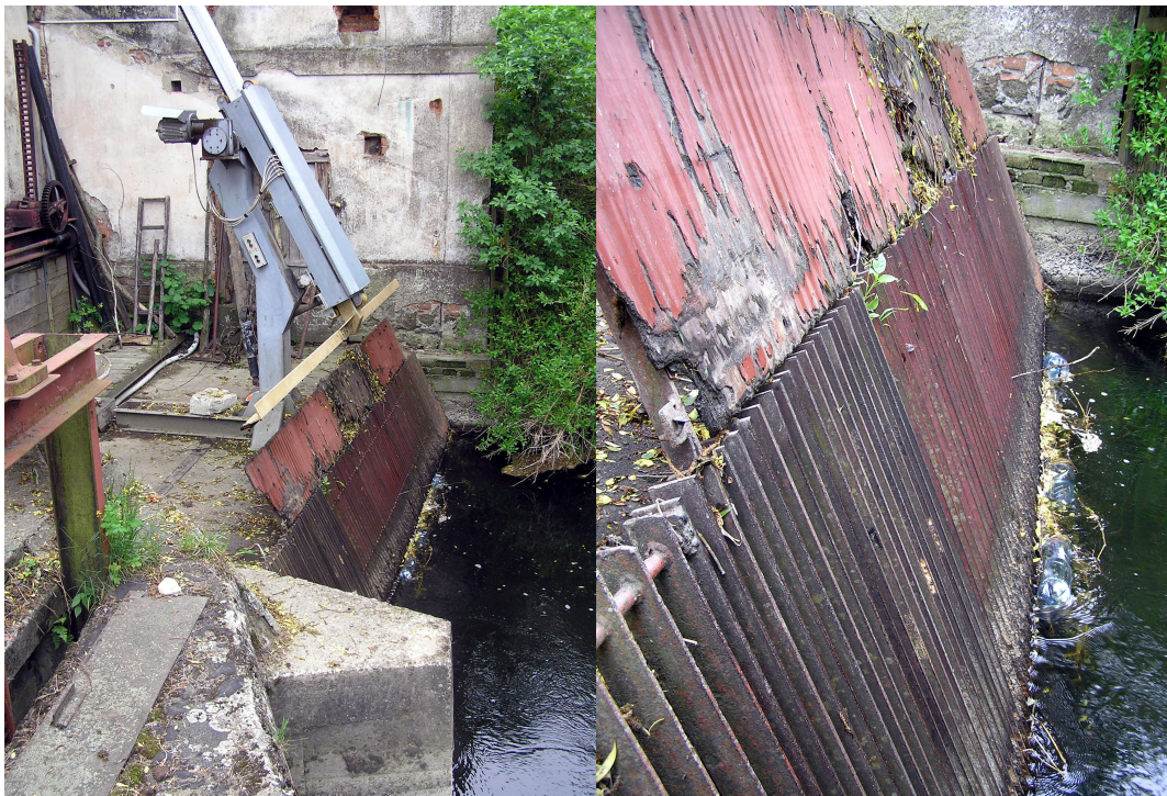
obrázek 5.2.3-3 Pohled na „hrábě“ a jemné česlice. [4]
