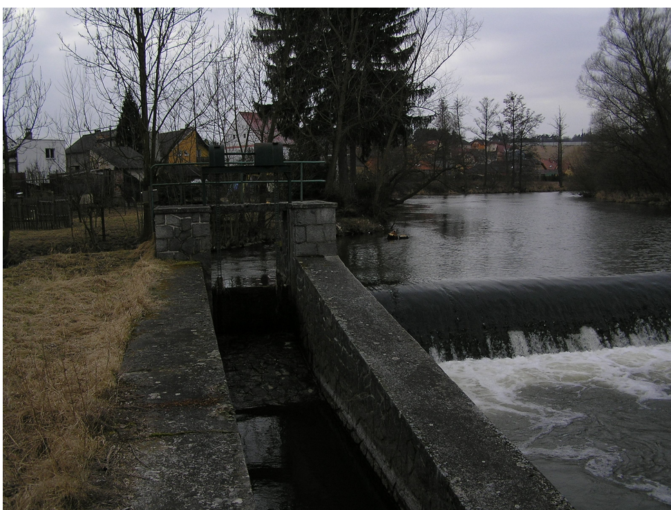
obrázek 5.2.1-2 Propust se stavidlem na pravém břehu. [4]
