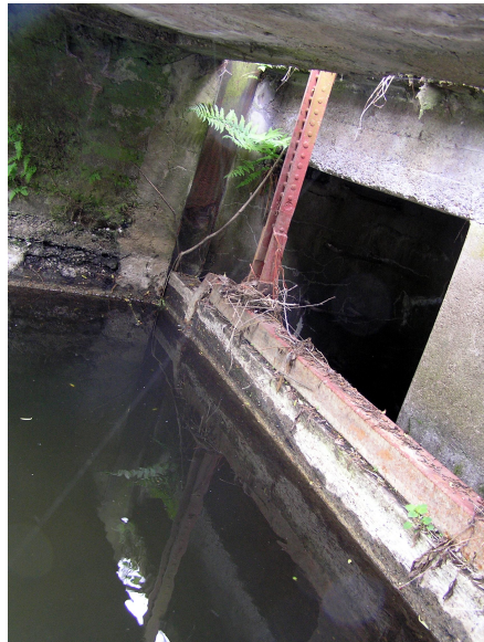
obrázek 5.2.3-4 Spuštěné stavidlo u neobsazené kašny. [4]
