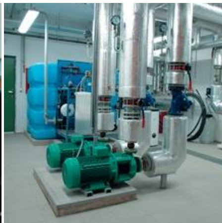
Obr. 9. Oběhová čerpadla topné vody[7]
