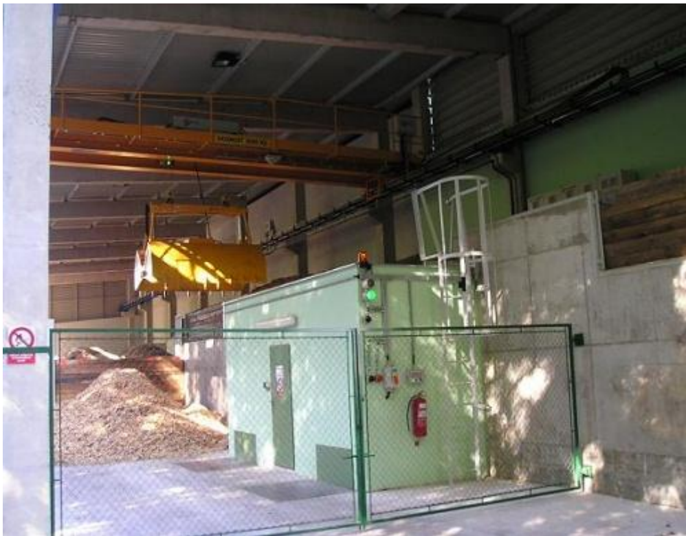
Obr. 13. Sklad paliva s mostovým jeřábem [6]
