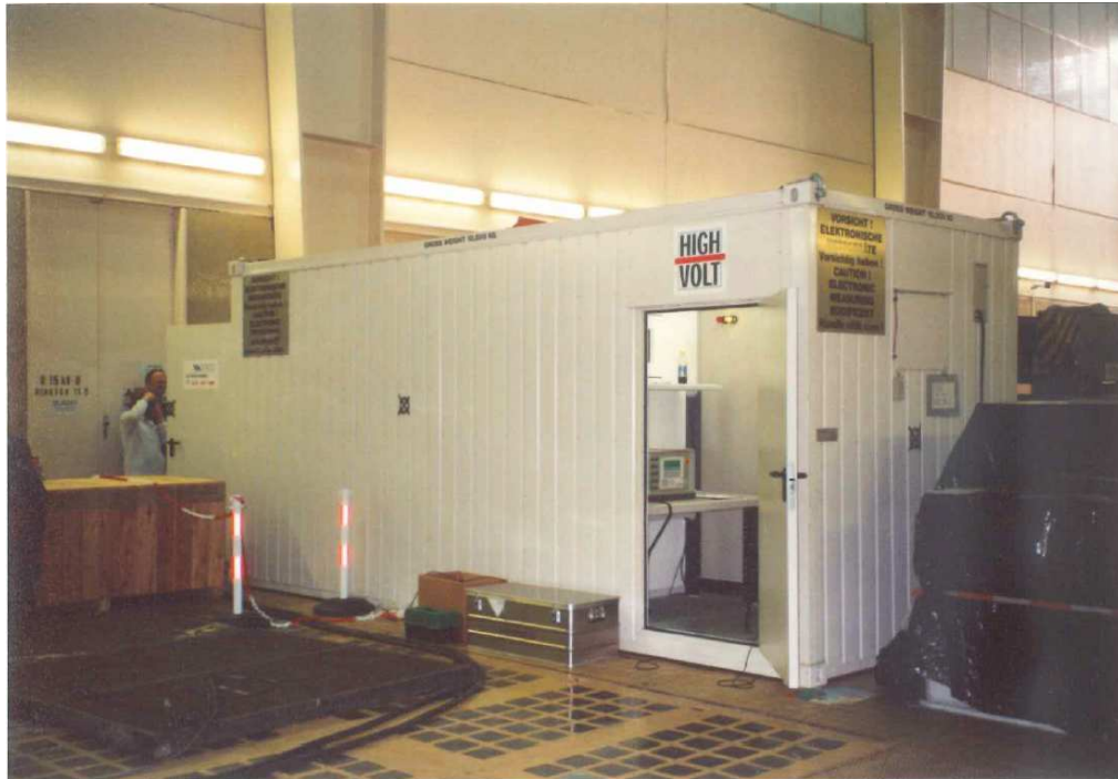
Obr. 53 : VN zkušebna položená ve strojovně
