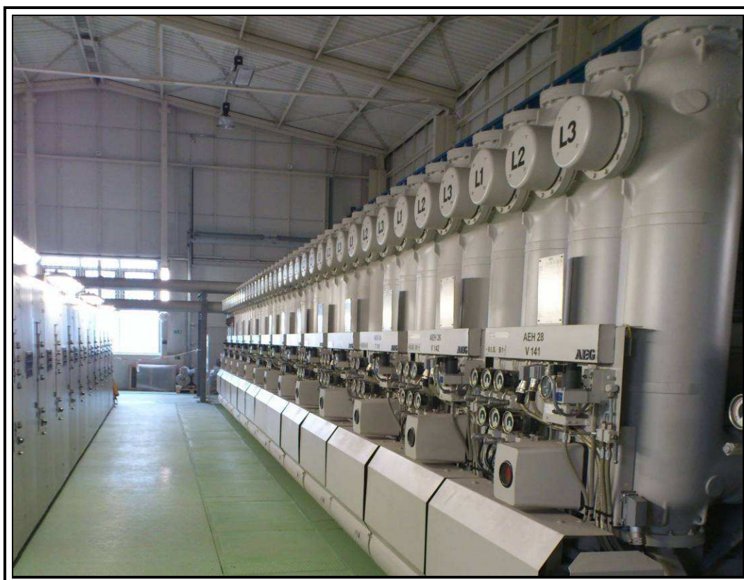
Obr. 2 – Vypínače 110 kV v provedení GIS
