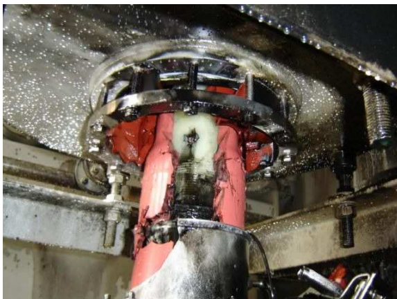
Obr. 6 Zničený vývod zapouzdřeného vodiče 132 kV [26]
