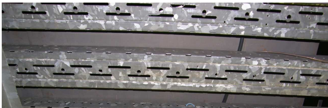
Obr. č. 3: Kabelové žlaby [8]
