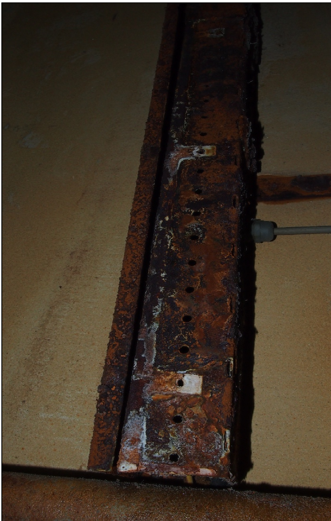
Příloha č. 2: Kabelový žlab pro uložení kabelů
