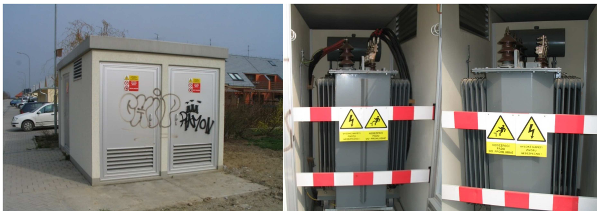
Obr. 3.3 Kiosková TS se dvěma transformátory (1. DTR v provozu, 2. DTR mimo provoz – náhradní, pro případ navýšení počtu zákazníků v dané lokalitě ) [19]
