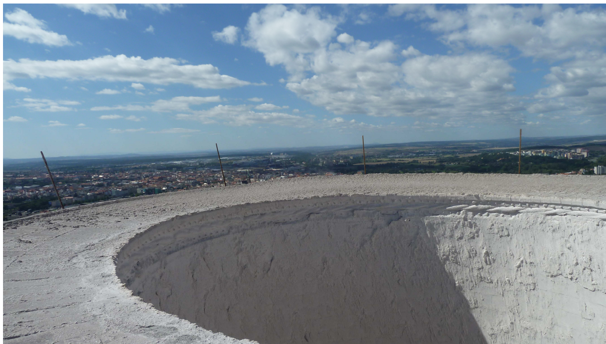
Obr. 20: Dmychadlo komína nese po letech provozu stopy po aditivech. Fotografie pořízená při výstupu na komín PT (170 m) dne 8.9. 2012.
