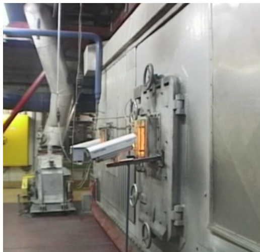
Obr. č. 18 Průzor do spalovací komory Termizo Liberec [4]
