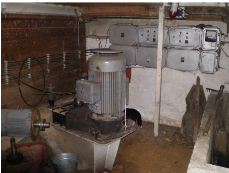
Obrázek 12 Celkový pohled strojovna
