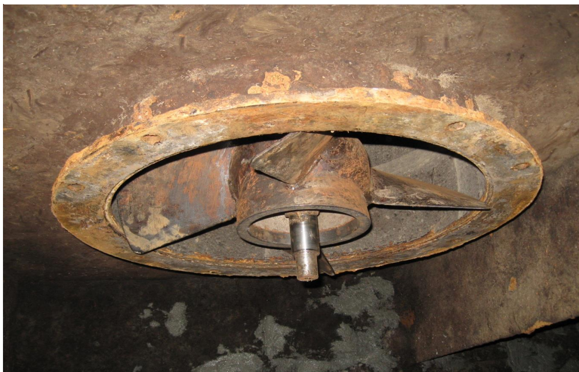
Obrázek 14 Detail vrtule MT5 po odmontování rozváděcího kola
