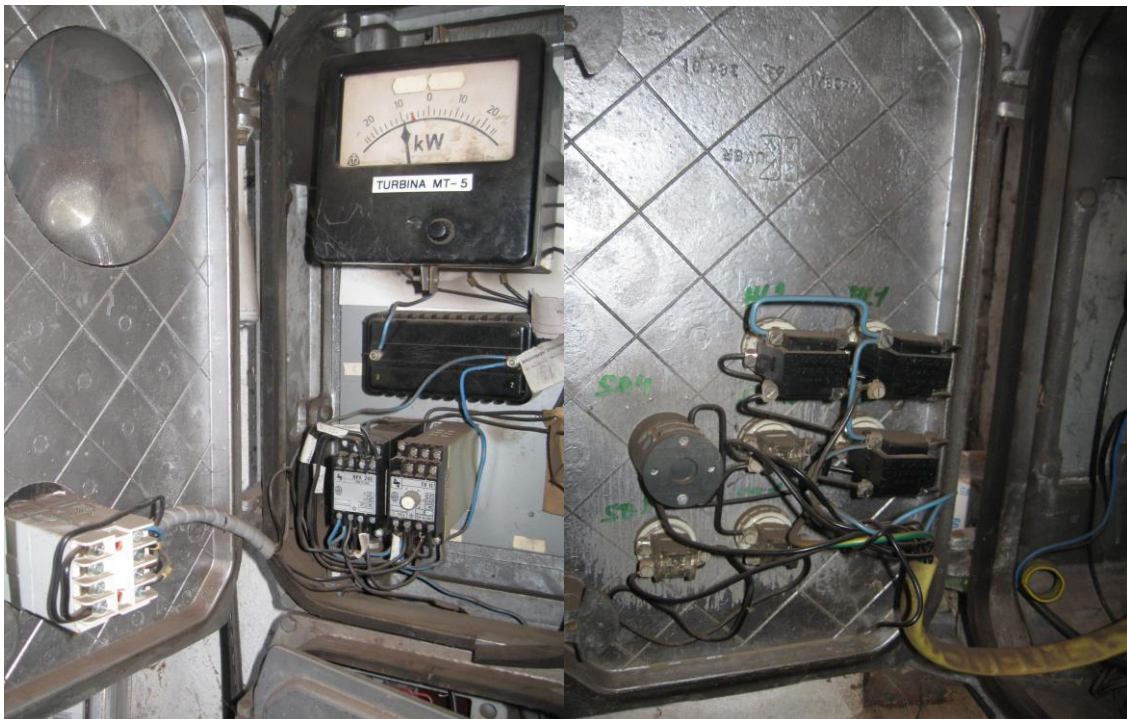
Obrázek 28 Rozvaděče před montáží zařízení pro vzdálený dohled a ovládání
