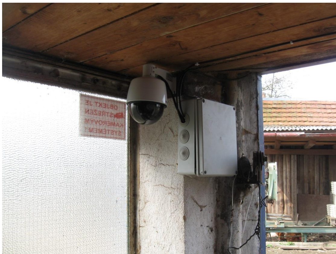
Obrázek 39 -Detail vchodu po montáži PTZ IP kamery pro vzdálený dohled provozu MVE
