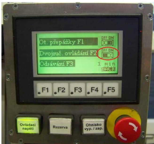
Obrázek 3-14 PLC panel - Dvojruční ovládání
