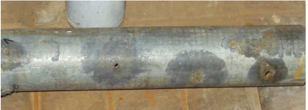
Obr. 2.6. Důlková koroze na povrchu trubky, [8].
