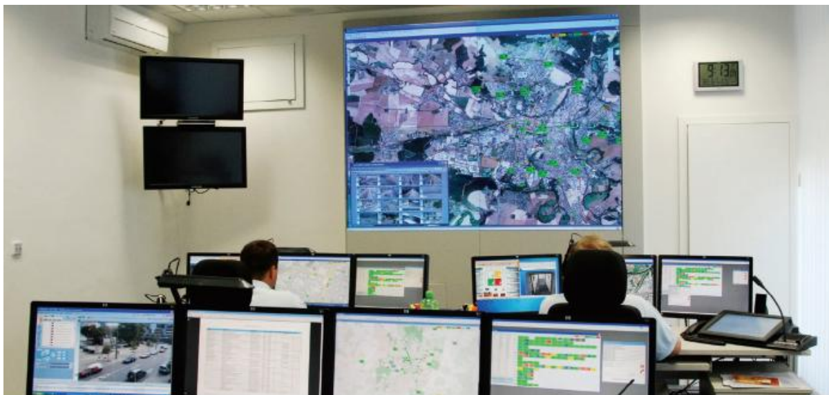
Obr. 3 Nové pracoviště dispečerů včetně zobrazovací stěny
