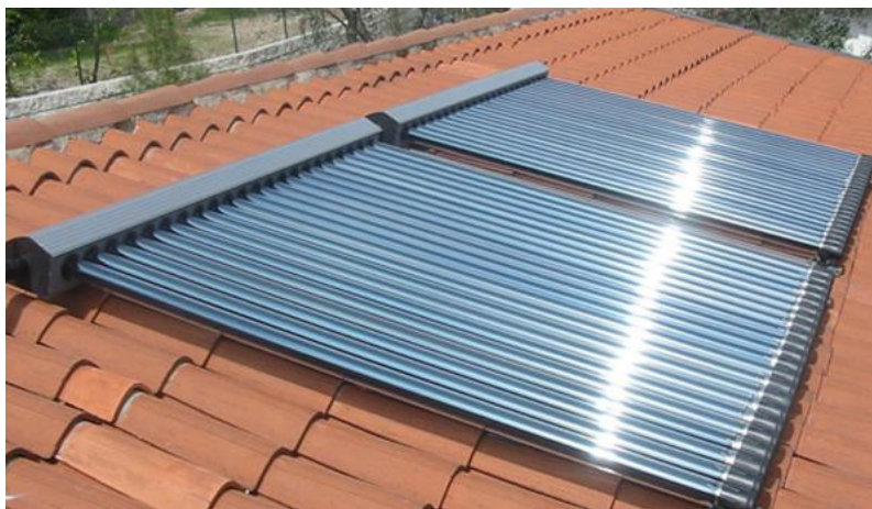
Obr. 21 Solární kolektor na střeše domu [14]
