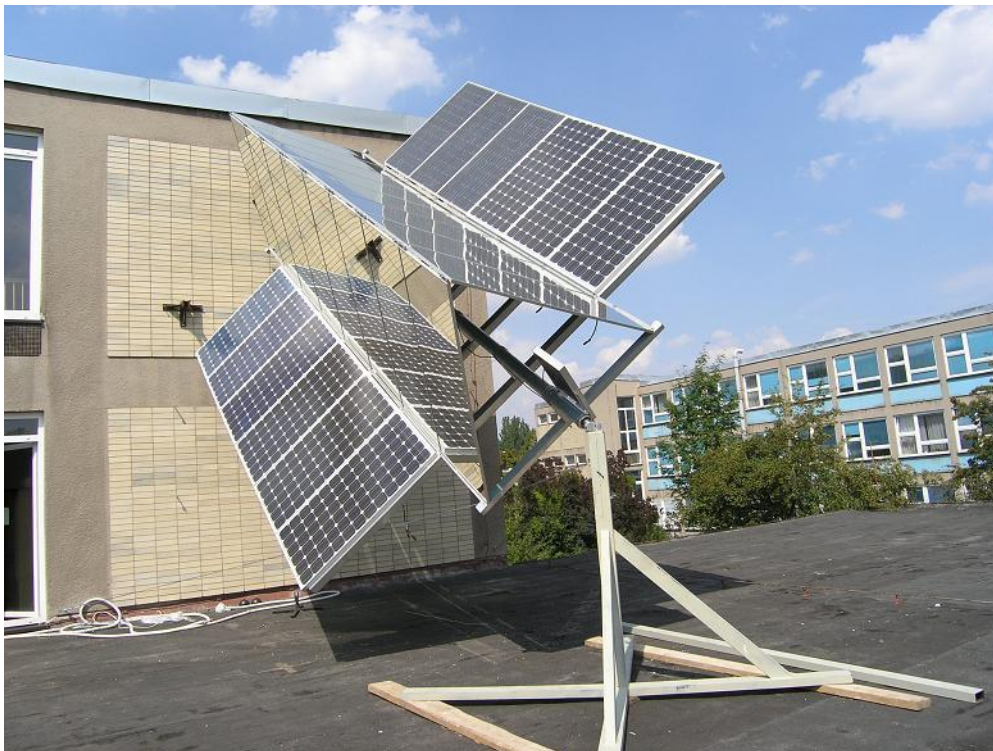
Obr. 18 PV systém TRAXLE s hřebenovým koncentrátorem [14]
