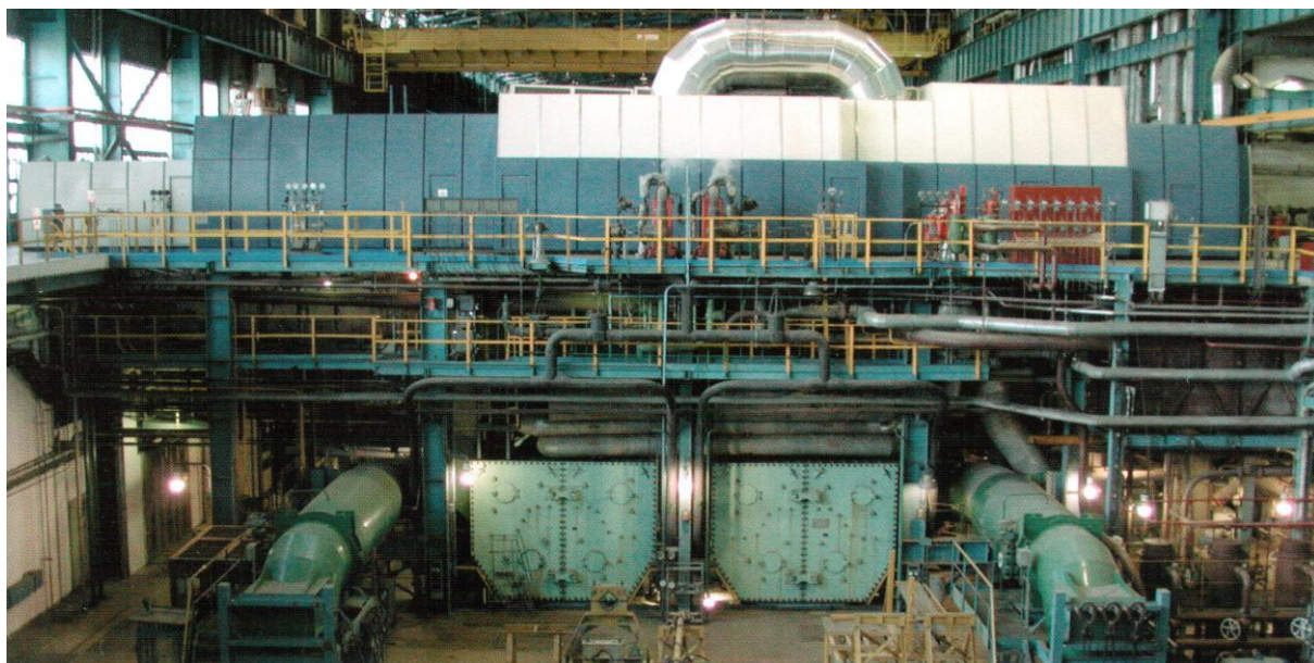
Příloha 3 Turbína a generátor, elektrárna Pruněřov II [15]
