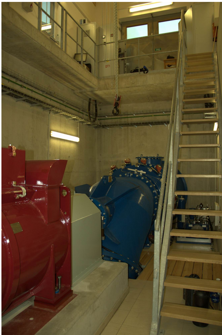
Obr. 4. Pohled od turbíny s generátorem
