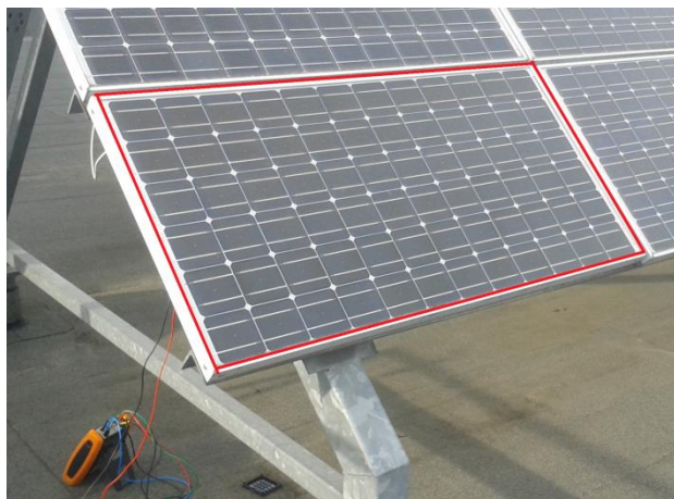
Obr. 4.2 Fotovoltaický panel na střeše ZČU
