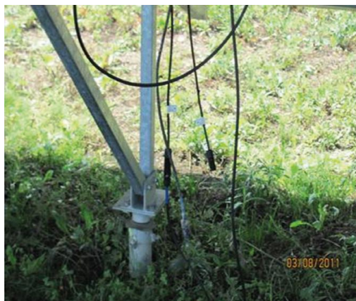
Obr. 3.15 Roztržené kabely pasoucí se zvěří [19]
