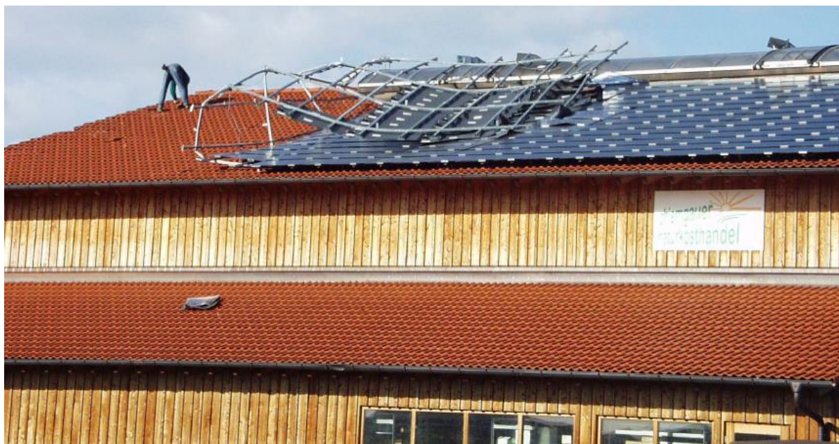
Obr. 3.18 FVE na rodinném domě po účincích větru [21]
