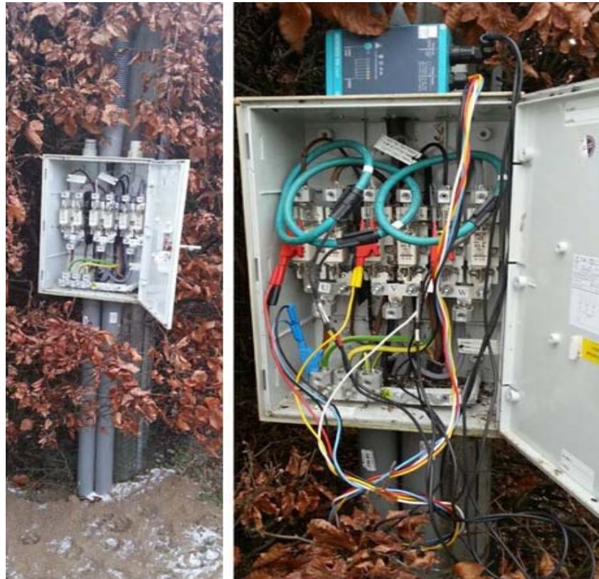
Obrázek 5.4: Elektrická skříň u domu číslo 20 prázdná a s připojeným kvalitoměrem
