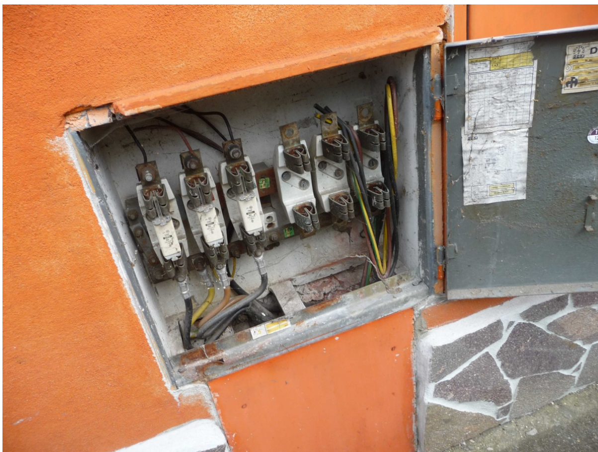
Obr. 2.2 Pojistková skříň z betonového prefabrikátu se zakrytým kabelovým prostorem plechem
