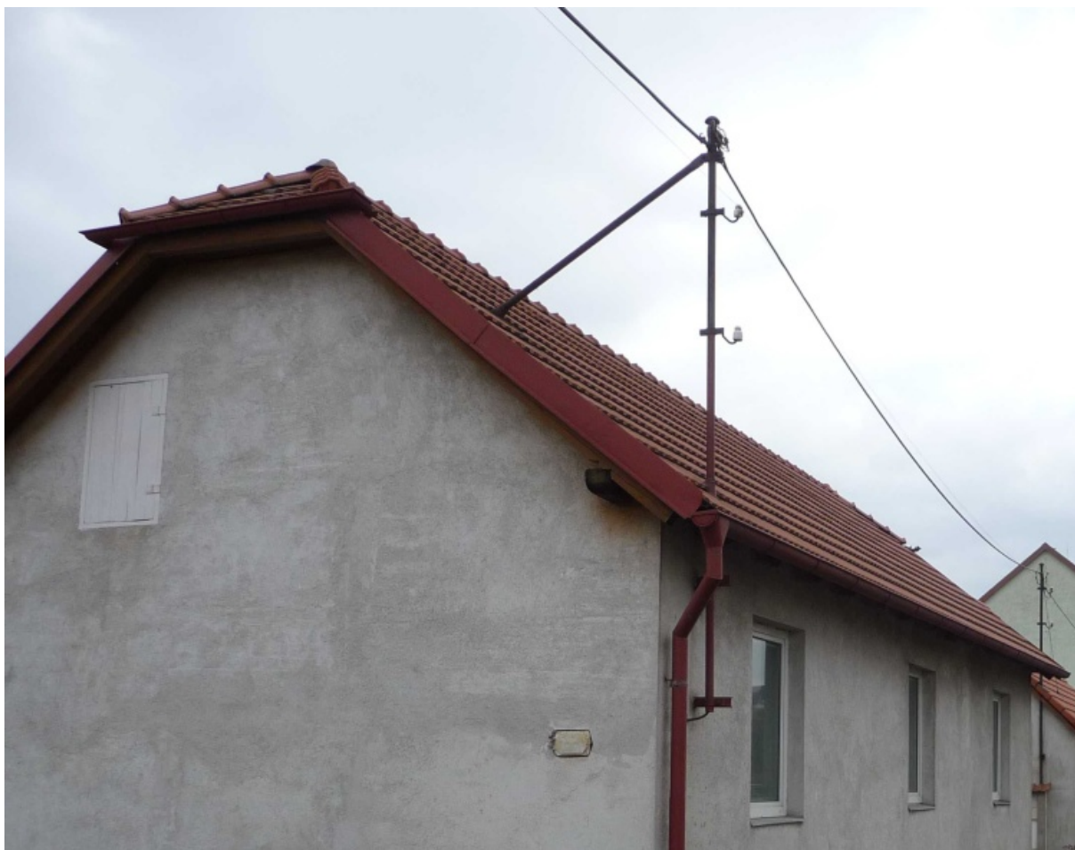
Obr. 2.1 Střešník se vzpěrou a celokovová pojistková skříň
