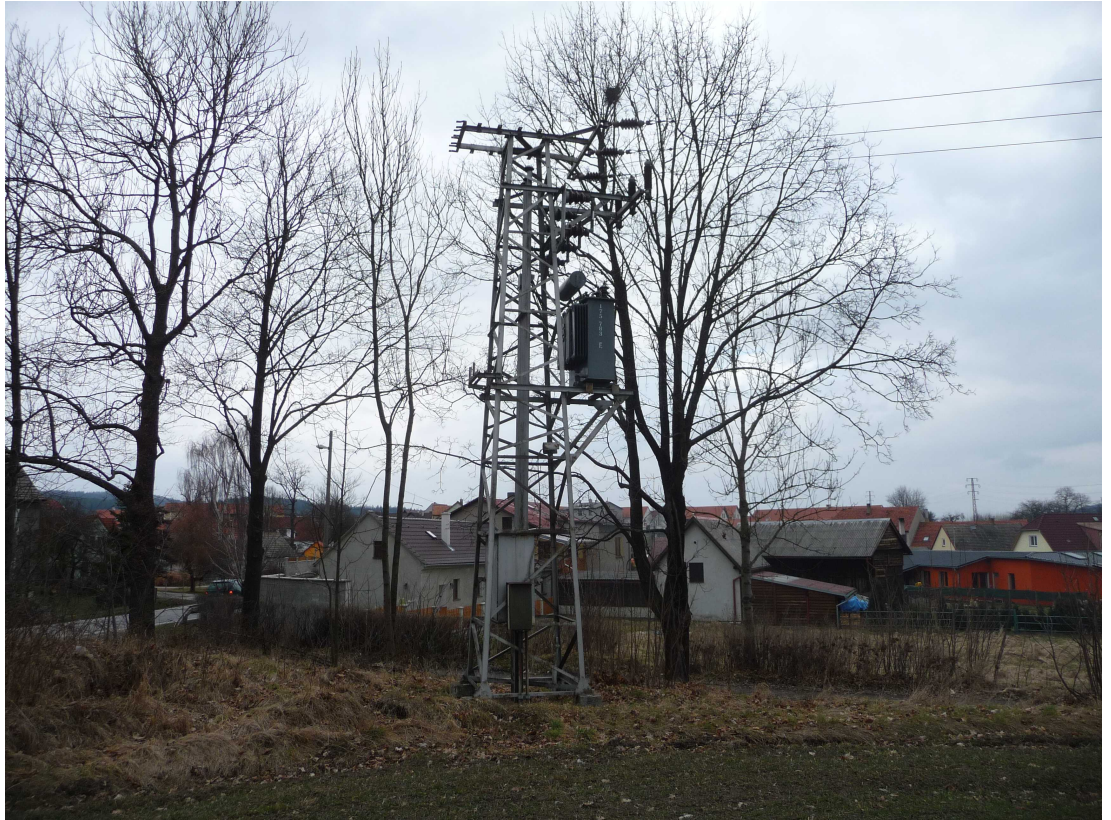
Obr. 1.4 Příhradová trafostanice Přísečná obec
