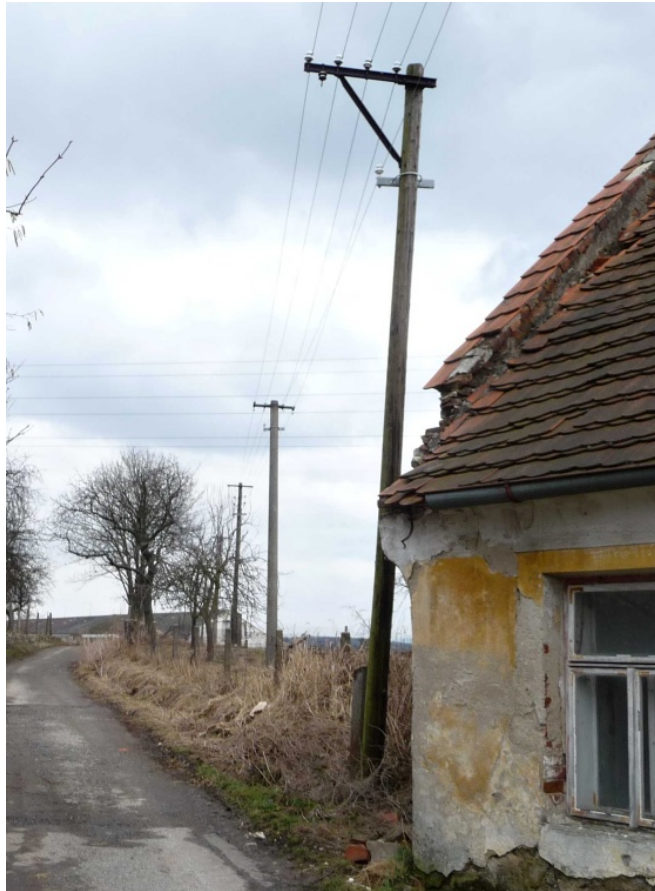
Obr. 1.2 Dřevěné sloupy s holým venkovním vedením
