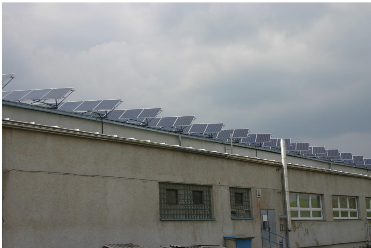
Obr. č. 16 Panely na střeše výrobní haly.
