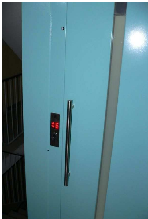
Obr.č. 22 - Vnější ovládací panel výtahu
