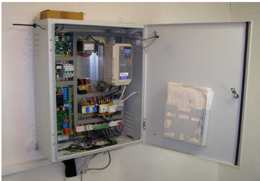
Obr.č. 13 - Rozváděč výtahu
