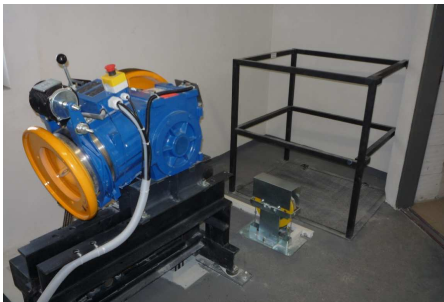
Obr.č. 12 - Pohon výtahu
