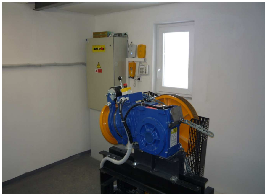
Obr.č. 11 - Strojovna s pohonem výtahu a rozváděčem
