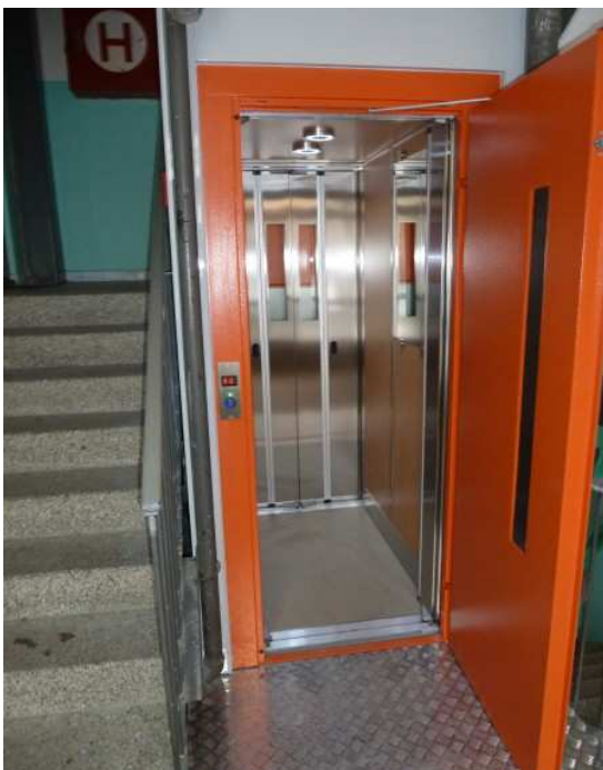
Obr.č. 1 - Modernizovaný výtah s průchozí kabinou
