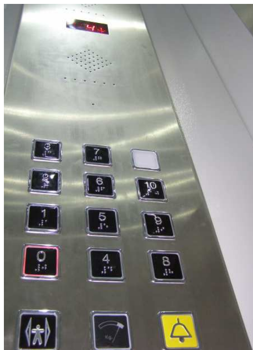
Obr.č. 23 - Vnitřní ovládací panel výtahu
