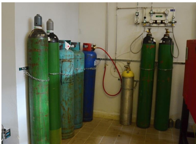
Obr. 3.2-4 Skladování plynů v místnosti UU006
