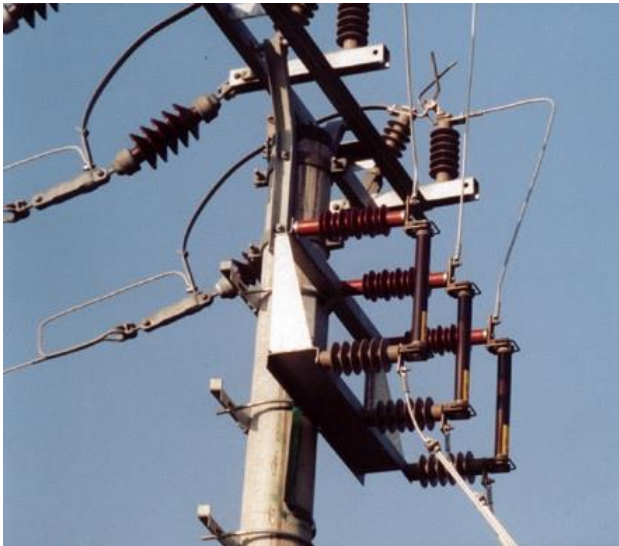
Obr. 4-2: Omezovač přepětí jako součást vybavení sloupové transformovny [30]
