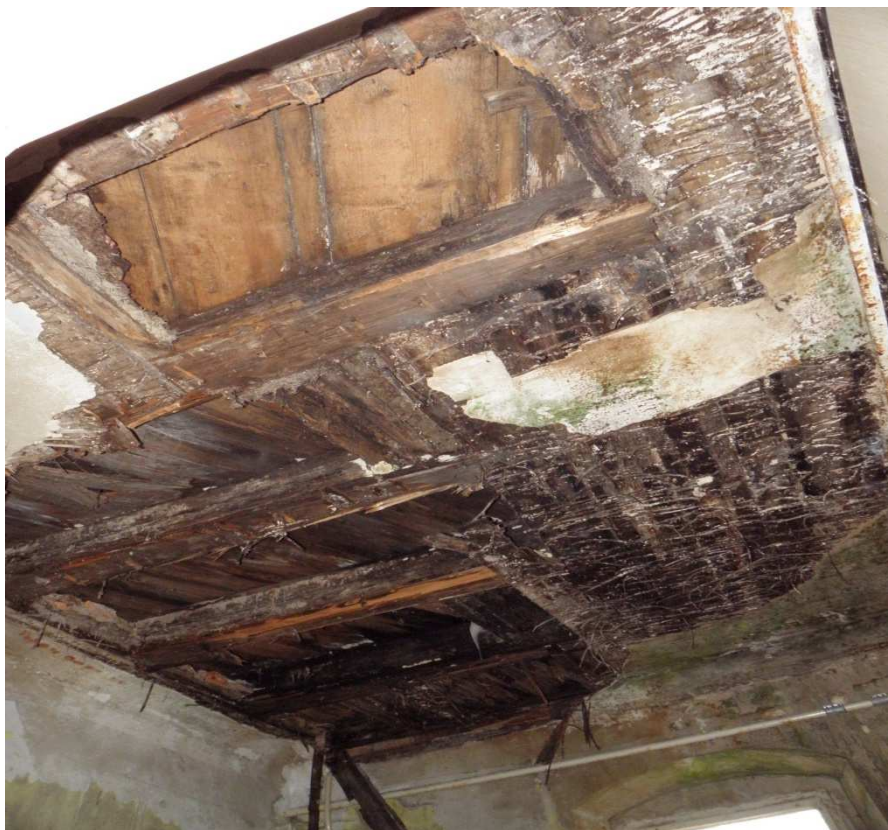
Obr. 32 propadlý strop v přízemí
