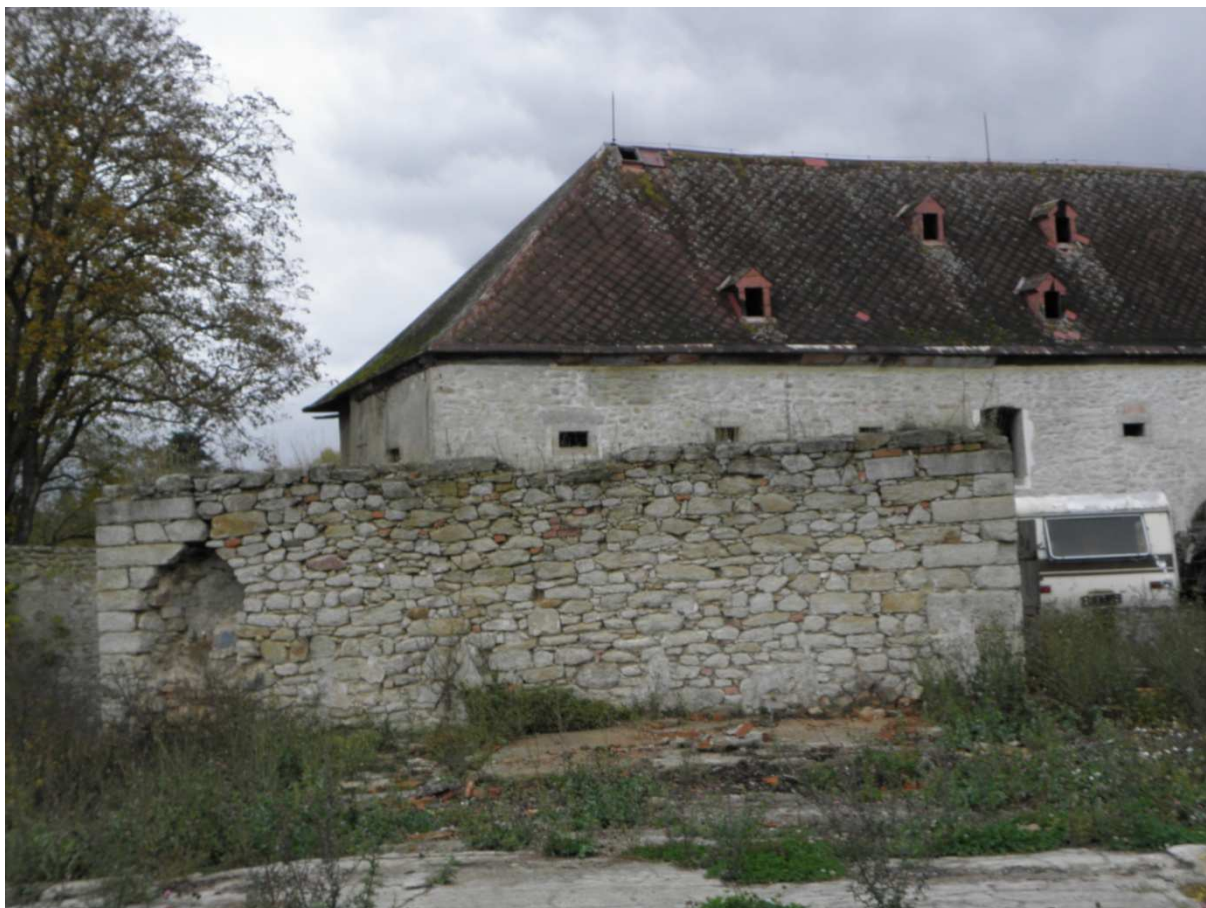
Obr. 16 destruovaný objekt na jižní straně předhradí zobrazený na obr. 10, 11 a 14. Snímek nebyl pořízen ze stejného místa, nicméně vzhledem ke stavu reliktvů má dostatečnou vypovídací hodnotu
