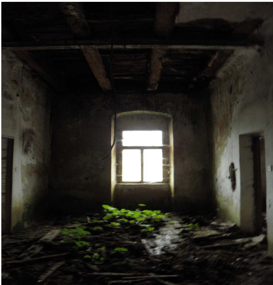
Obr. 34 ztrouchnivělá konstrukce v patře ve ve východním bytu situovaném ve východní části jižního traktu. Humózní vrstvy, z nichž vyrůstají náletové rostliny se nachází jak v patře, tak i v mansardě.
