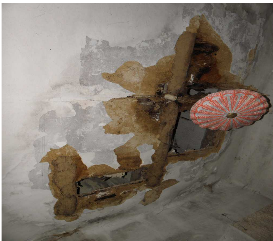
Obr. 33 poškození stropu v garsonce situované v severním traktu uprostřed budovy
