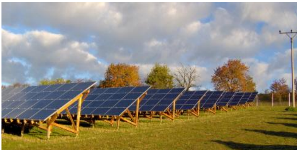
Obrázek 6: Dřevěné konstrukce se solárními moduly. [5]
