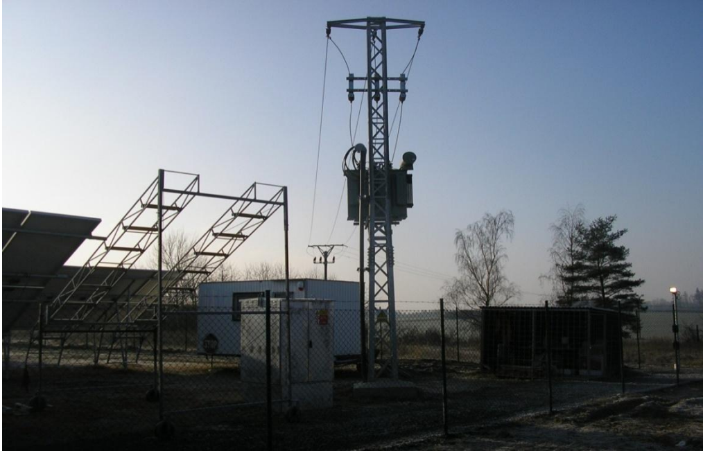
Obrázek 10: Transformace napětí na hladinu 22 kV – olejový sloupový transformátor.
