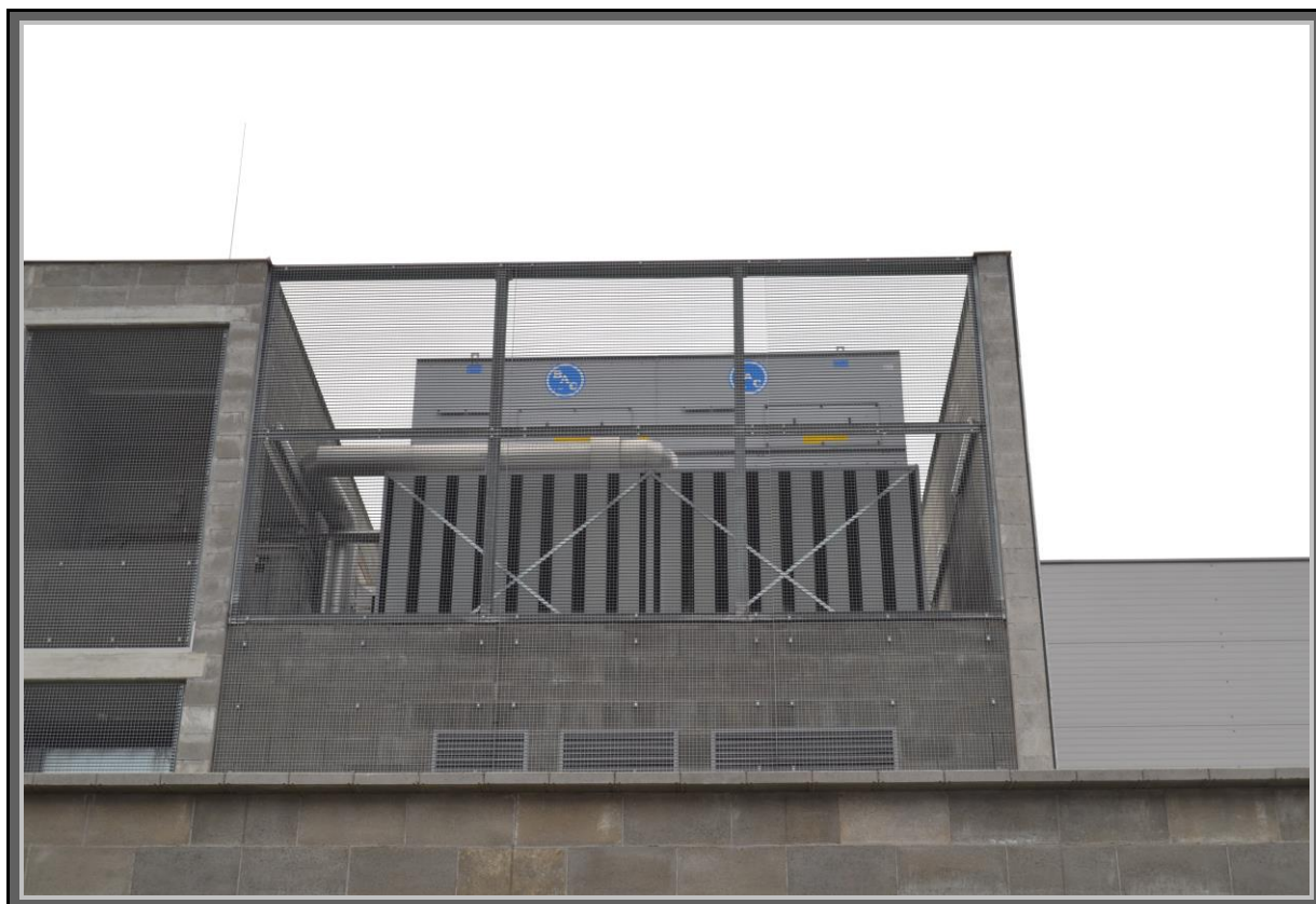
Obrázek 41 Chladicí věž na střeše budovy [41o]
