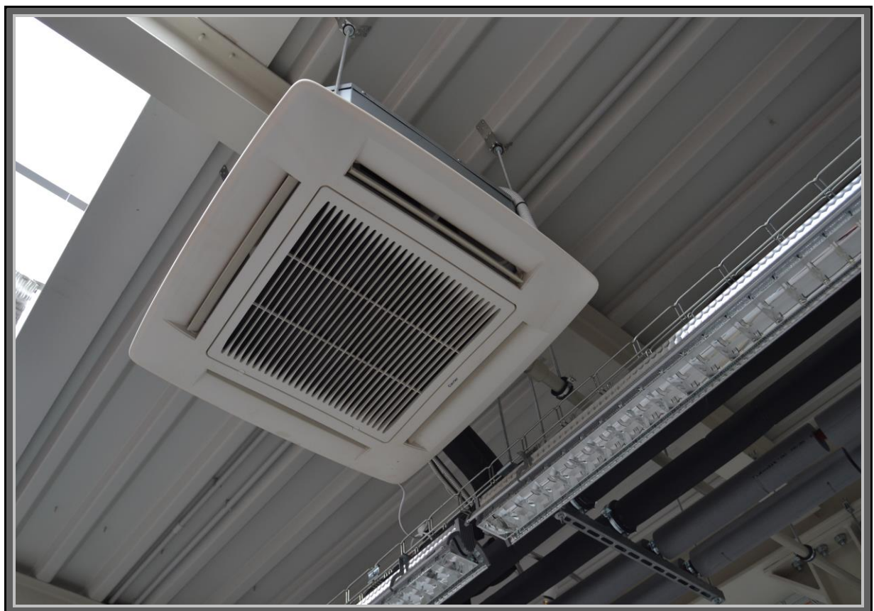
Obrázek 40 Klasická samostatná VZT jednotka [40o]
