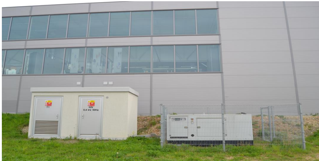
Obrázek 19 Trafostanice a dieselagregát za budovou školy[19o]
