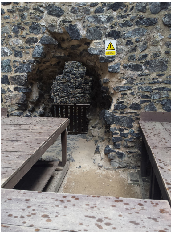
Obr. 12: Radyně. Detail novodobého otvoru do polookrouhlé věže.
