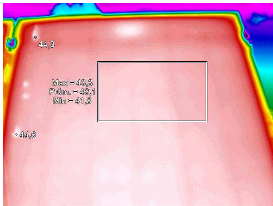
Obr. 4.6 Polykrystalický panel znečištěný ptačím trusem (uvedené teploty jsou v °C)
