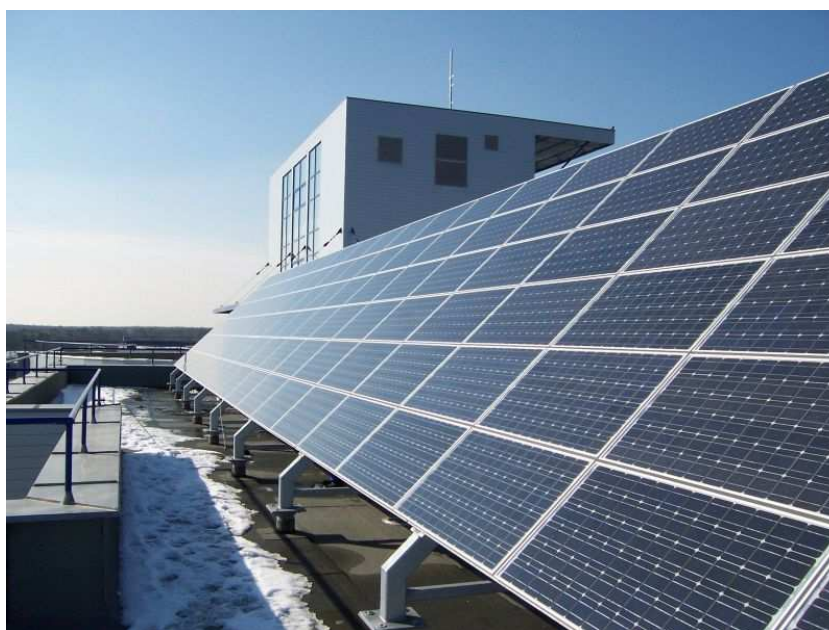
Obr. 3.1: Fotovoltaický systém na budově FEL ZČU. [10]
