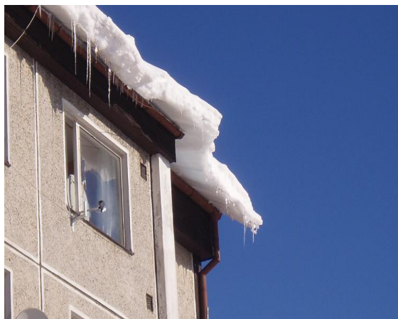
Obrázek 22: Vysunutí sněhové pokrývky přes okraj střechy
