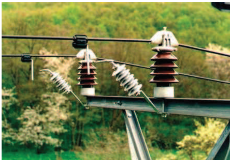
Obr. 17 Svodiče přepětí na izolovaném vedení, kombinace varistoru a jiskřiště [19]
