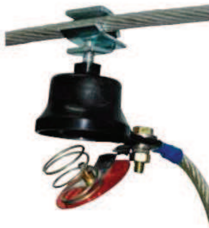
Obr. 19 Omezovač s vybaveným odpojovačem a otevřeným signalizačním víčkem při poruše [21]
