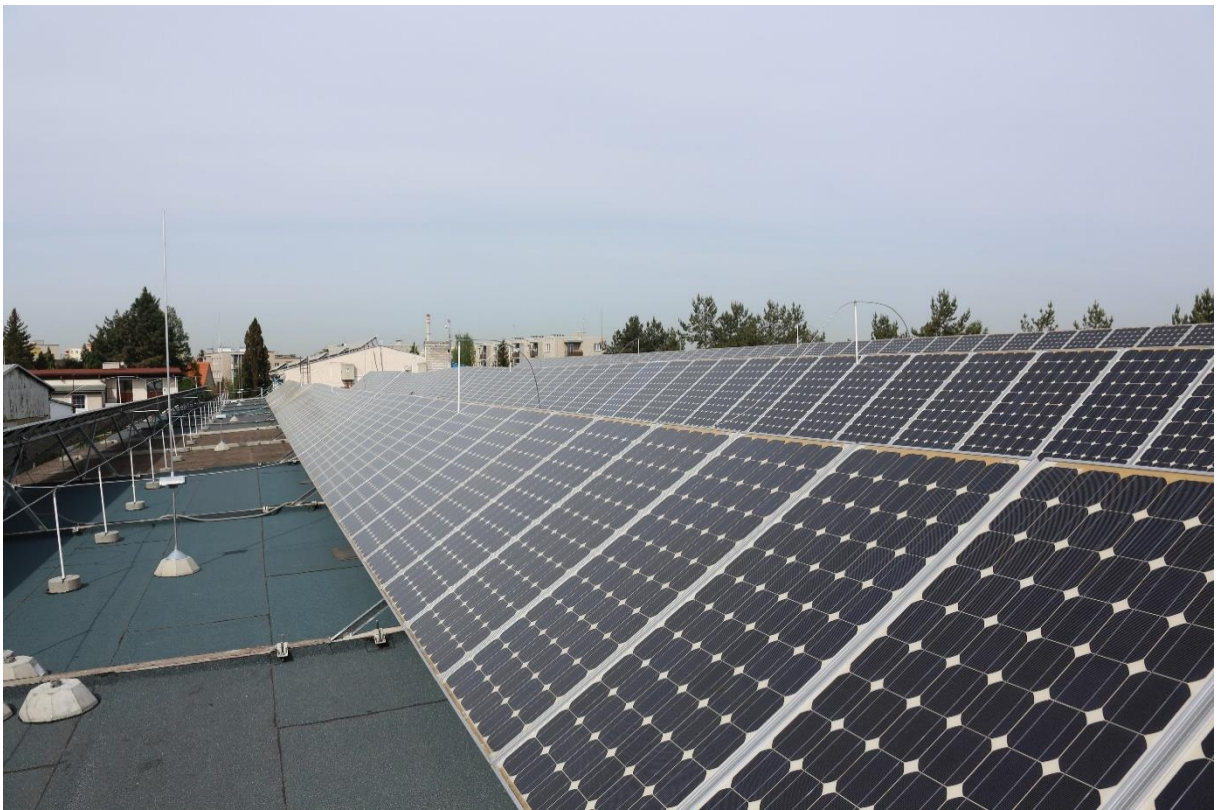
Obr. 4.2.1. Pohled na fotovoltaickou elektrárnu na střeše budovy
