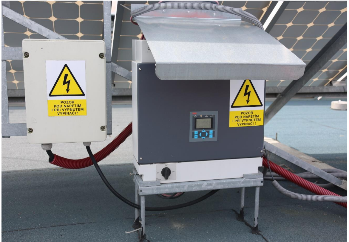
Obr. 4.1.1. Měníč na střeše budovy
