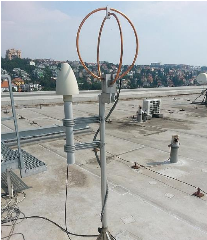
Obr. č. 8. Detektor sítě LINET na střeše budovy MFF UK v Praze.
