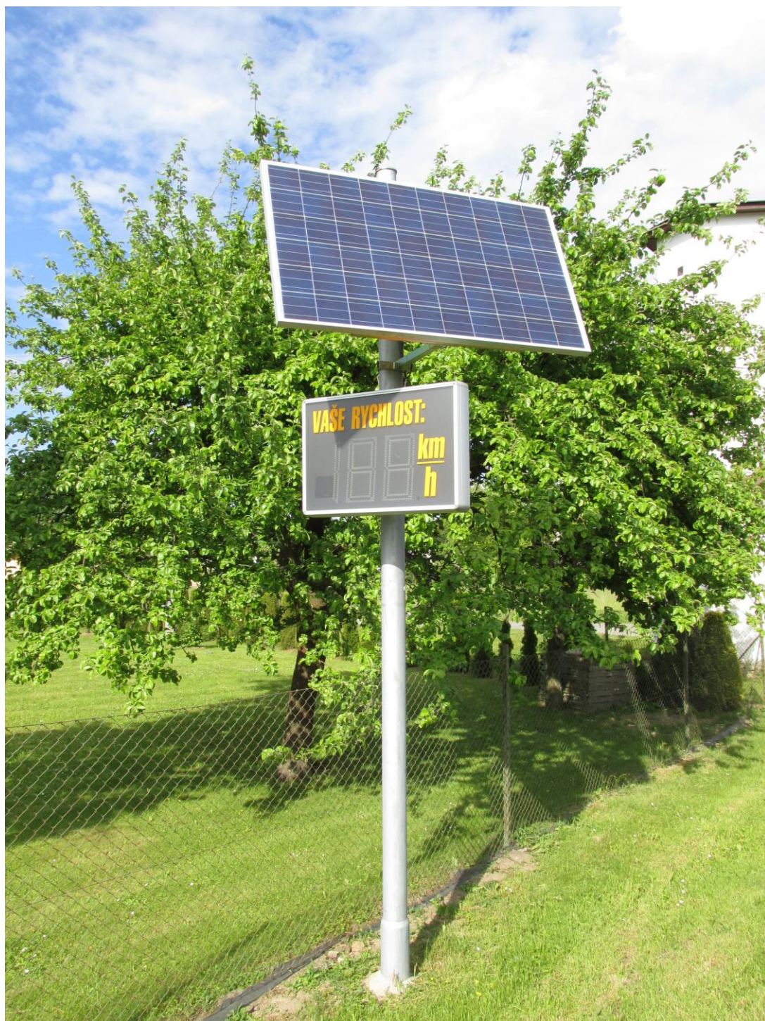
Obr. 23: Finální instalace IPR10 v ostrovním provozu v obci Petrovice u Humpolce
