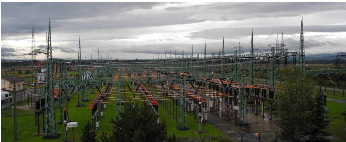
Obrázek 4: TS Dasný 110 kV
