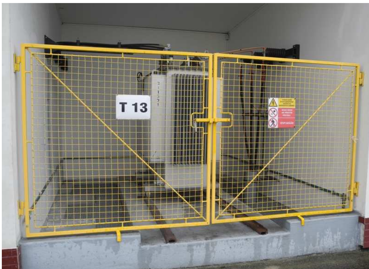
Obrázek 38: RS Dasný - jeden z transformátorů VS umístěný v betonové kobce
