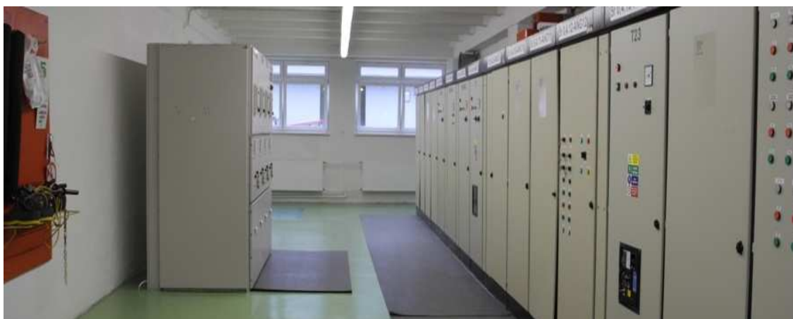
Obrázek 29: Rozvodné skříň VS - Dasný
