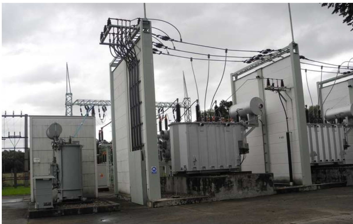
Obrázek 51: RS Mladé - dvojice transformátorů 110 kV a Petersenova zhášecí tlumivka
