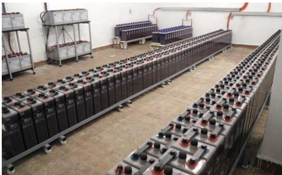
Obrázek 30: Akumulátorové baterie - RS Dasný
