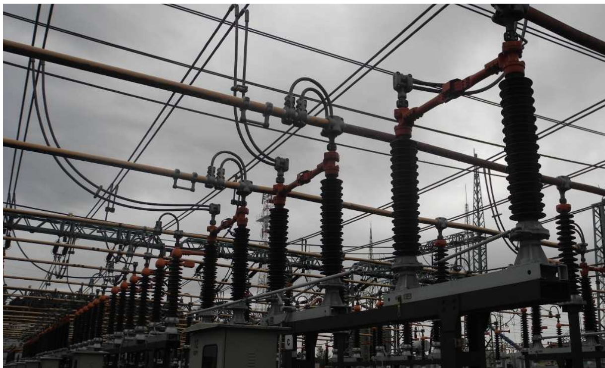
Obrázek 42: Detail na horizontální odpojovače 123 kV (Dasný)
