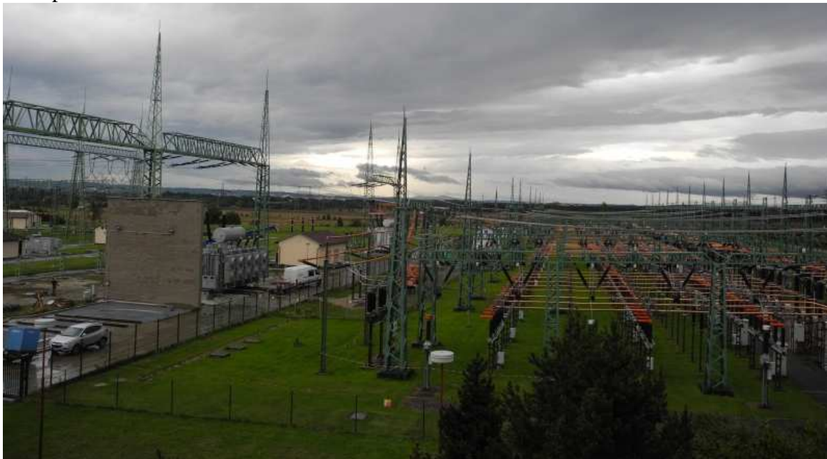
Obrázek 35: Celkový pohled na RS Dasný - rozdělení 400 kV a 110 kV části
