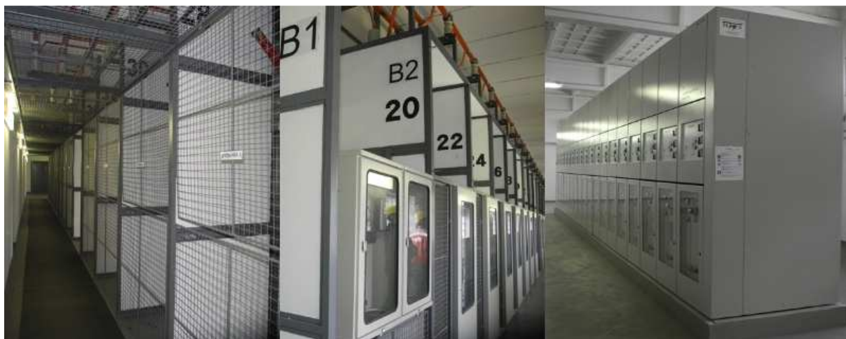
Obrázek 47: Provedení rozveden 22 kV - zleva: kobkové, skříňové a zapouzdřené
