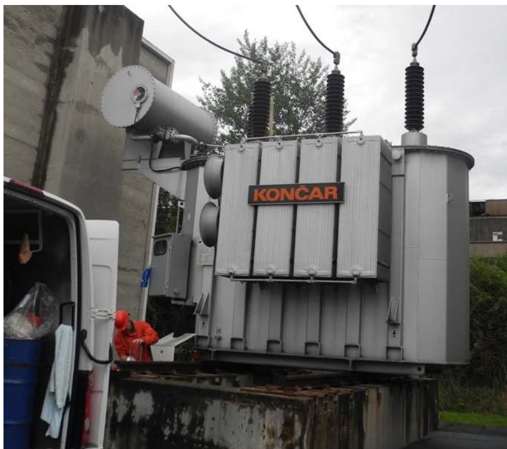
Obrázek 44: Transformátor v RS Škoda a zrovna probíhající revize
