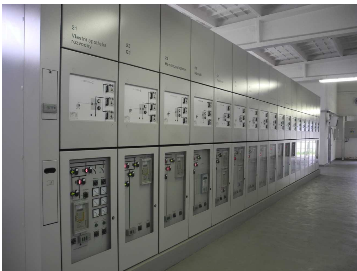
Obrázek 10: Zapouzdřená spínací stanice
