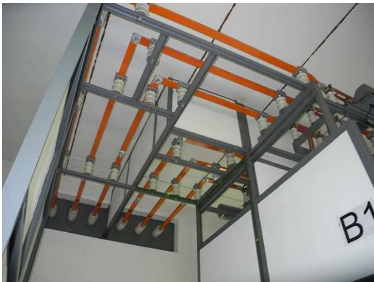
Obrázek 46: Provedení vnitřní rozvodny 22 kV - odbelňkové vodiče
