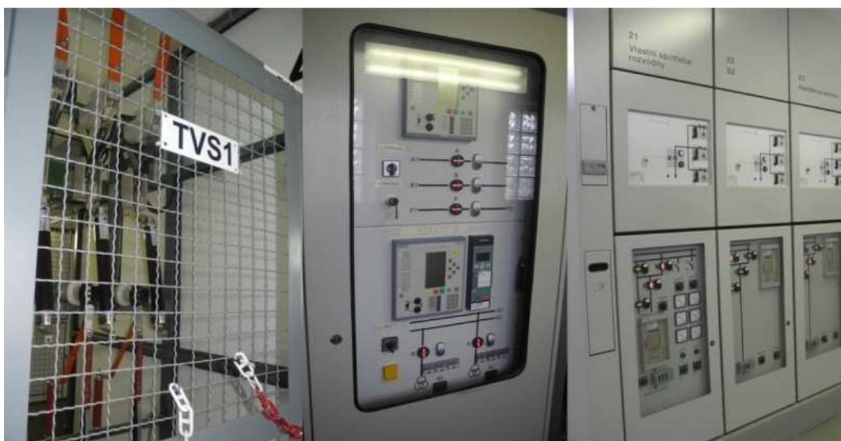
Obrázek 48: Detailnější pohled na provedení výše zmíněných rozveden 22 kV
