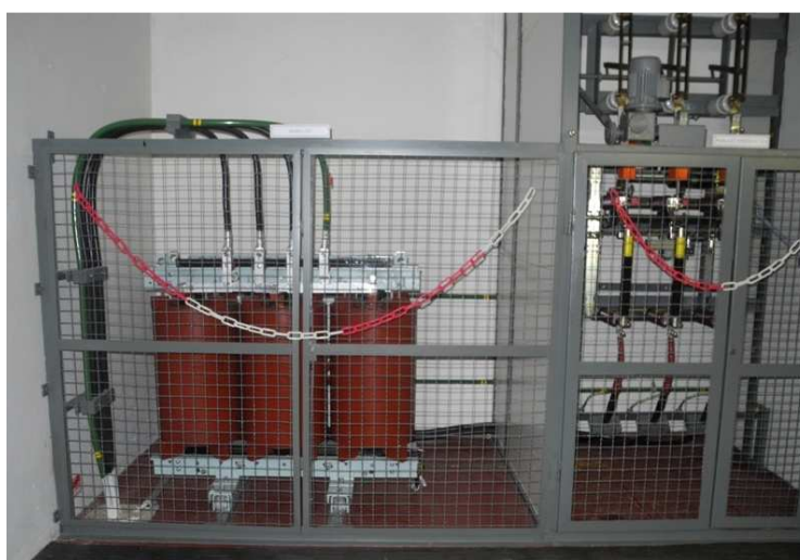
Obrázek 49: Suchý transformátor vlastní spotřeby
