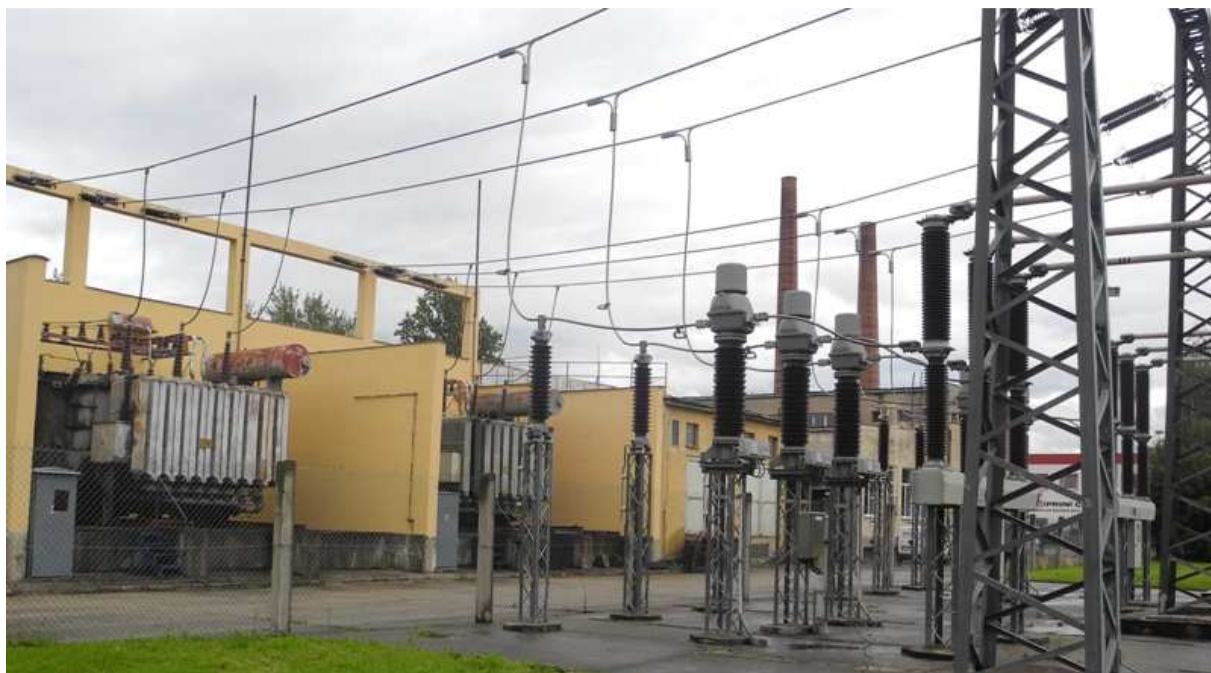
Obrázek 45: Vyvedení výkonu na transformátory slévárny Škoda, sloužící již přes 50 let
