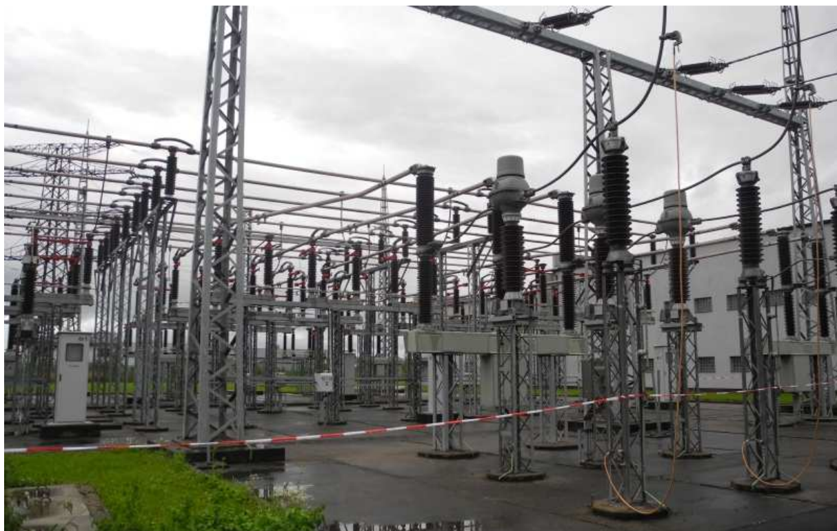
Obrázek 43: RS Škoda a pohled na zkratovací soupravu
