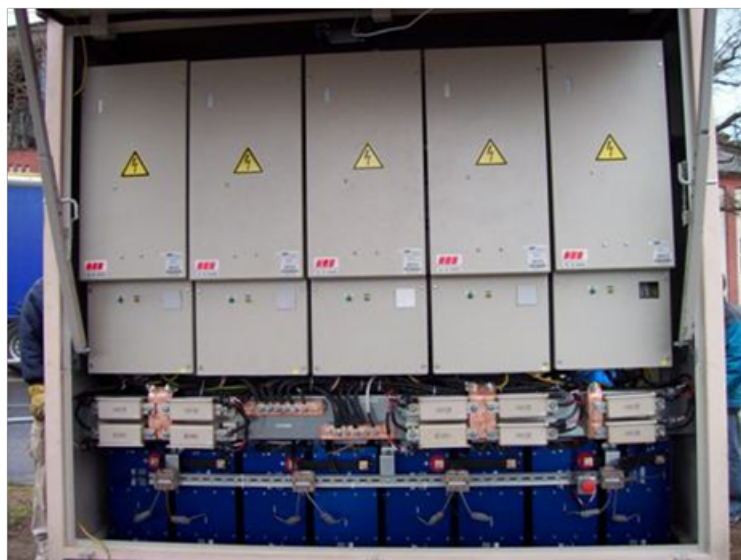
Obr. 6.2: Energetická posilovací stanice EPOS, převzato z [6]
