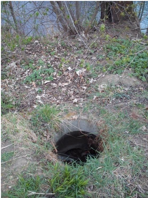
Obr. 9 Nezabezpečená skruž u řeky Mže (Zdroj: (7))
