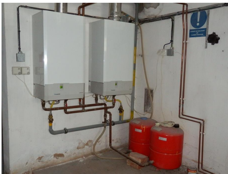
Obrázek 13: Plynové kotle vytápějící bytová dům
