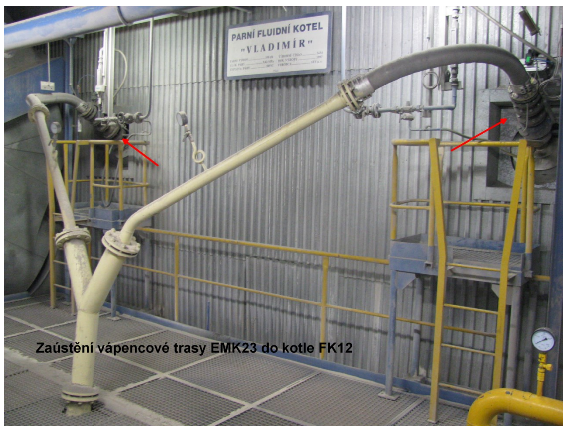
Obr. 4.4 Zaústění trasy vápence EMK23 do kotle FK12
