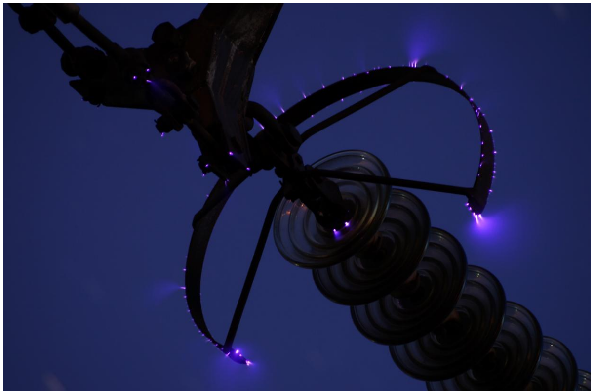
Obr. 4: Typický korónový výboj na izolátoru a armaturách [17]
