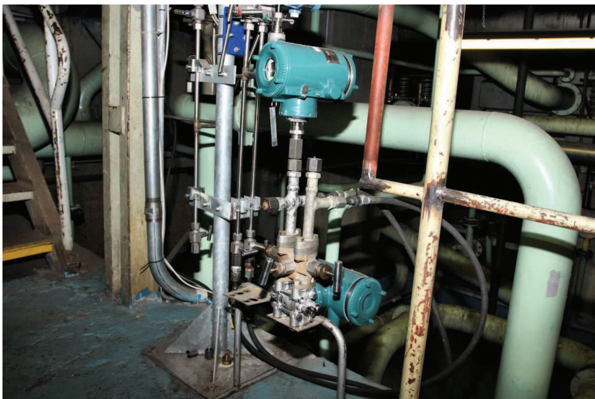
Obr. 27 - Nainstalovaný převodník tlaku na odběrové místo [vlastní zdroj]
