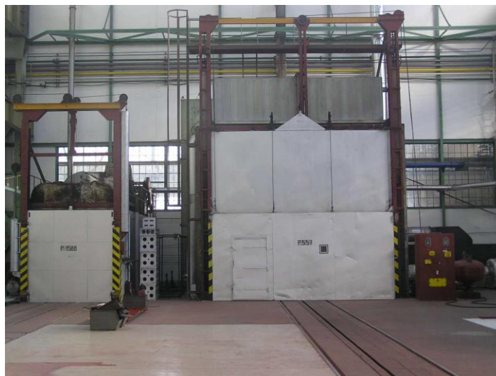
Obr. 19 Impregnační pece P1588 (vlevo) a P-577 (vpravo)
