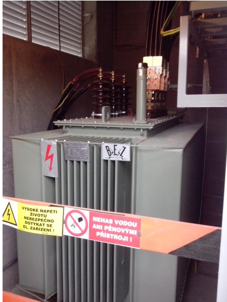
Příloha č. 7: Transformátor
