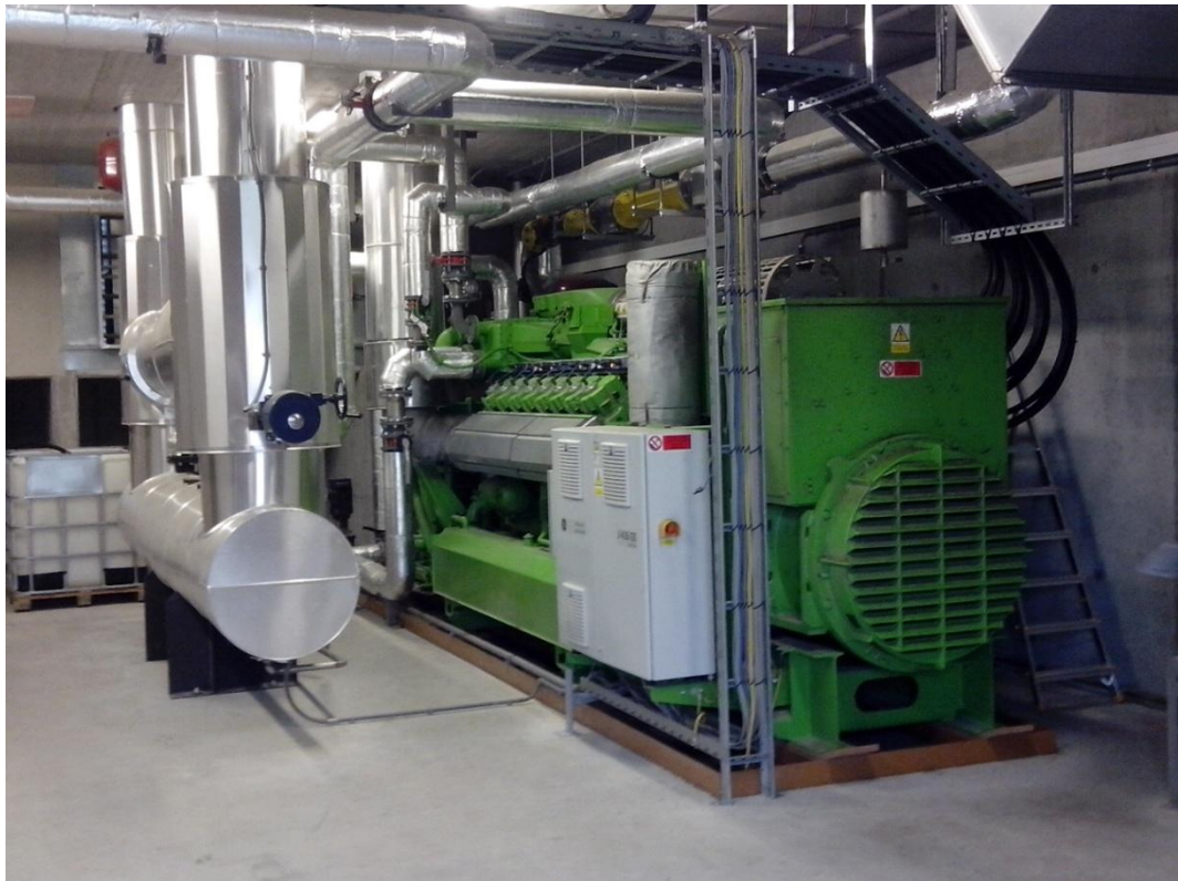
Příloha č. 5: Kogenerační jednotka BPS Třemošná
