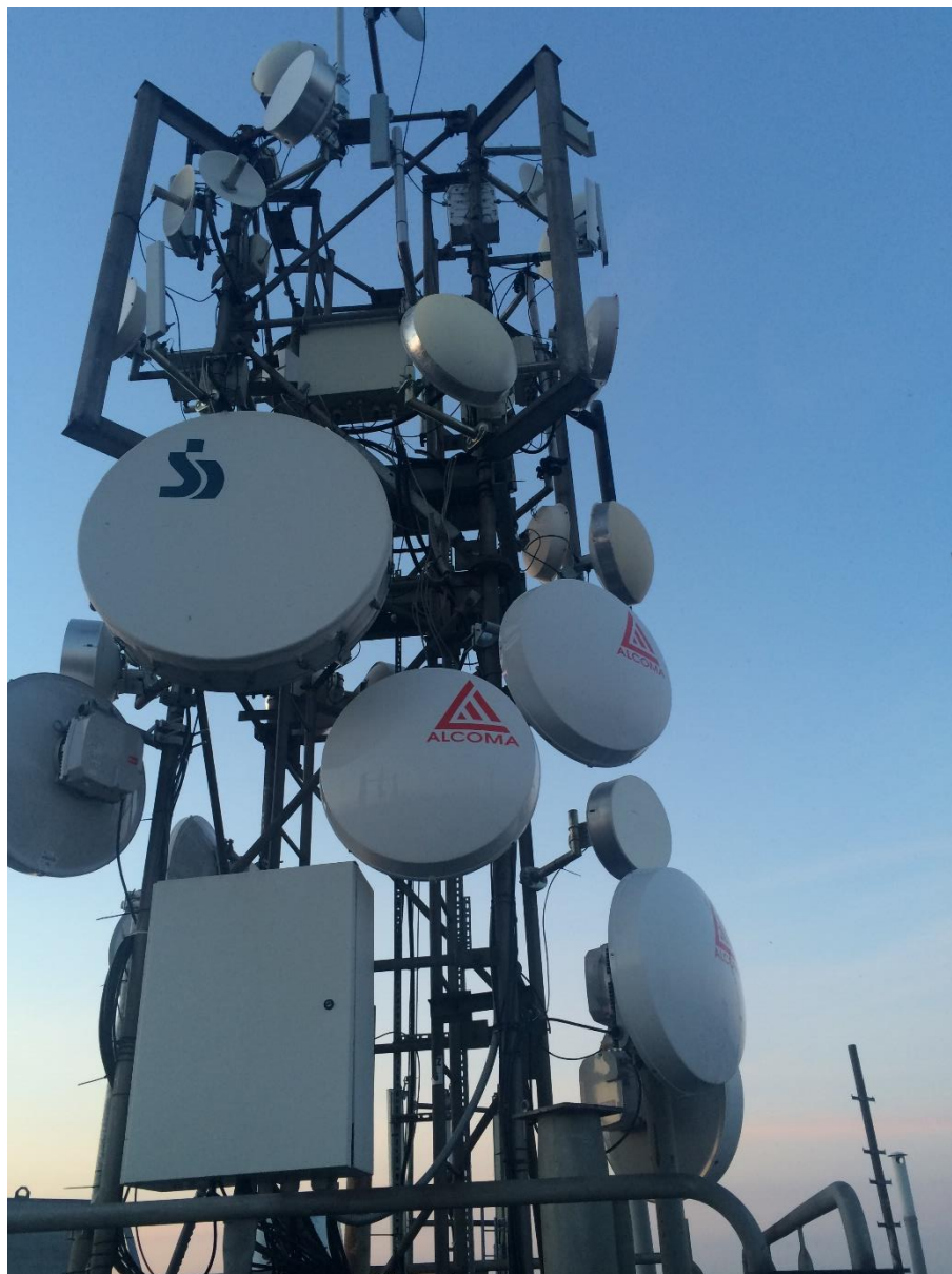
Obrázek 3 Stožár, na němž je umístěn 17 i 10 GHz spoj ALCOMA - lokální stanice
