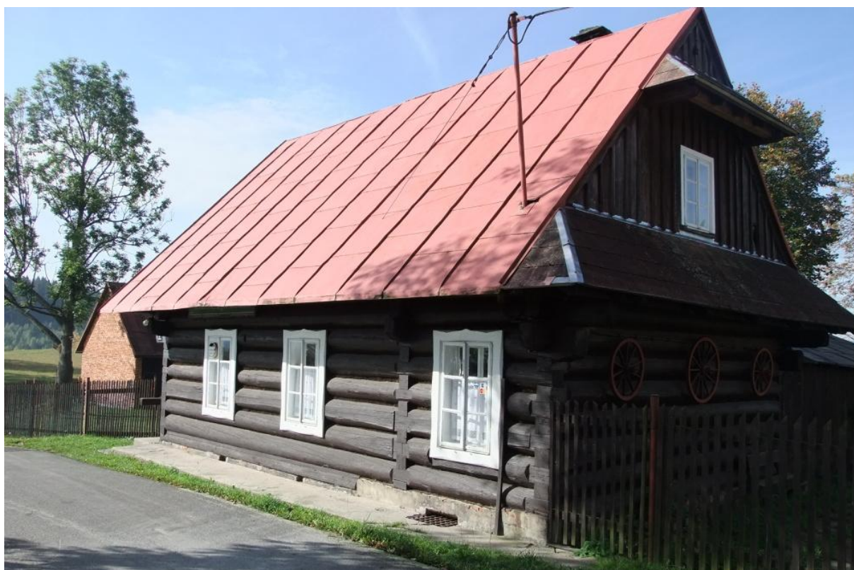
Obr. 7 Dům s podlomením v obci Hrčava (okr. Frýdek-Místek). Foto V. Petrová, 2013
