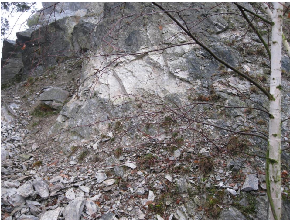
Obr. č. 9: Odpadávající jílovité břidlice (vlastní dokumentace)
