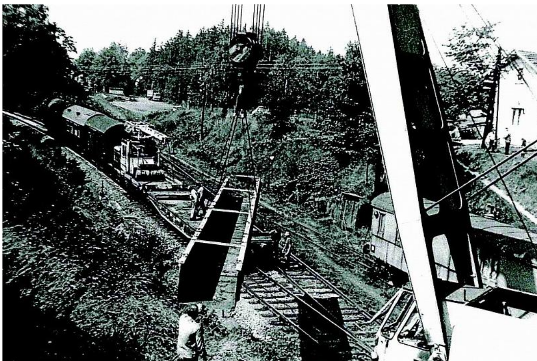
Obr. VIII – Stržení akvaduktu v roce 1984
