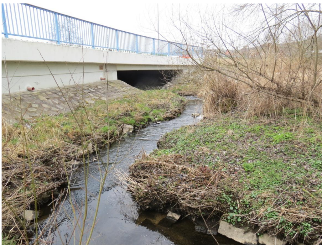
Obr. XL – Pohled na Teplou Bystřici při podtékání komunikace I/26
