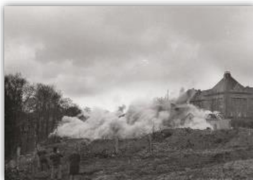
Fotografie č. 8 – Odstřel většiny bývalých lázeňských budov při rozšiřování Karlovarské třídy roku 1979. Zdroj: Soukromá sbírka Marcela Votlučky.
