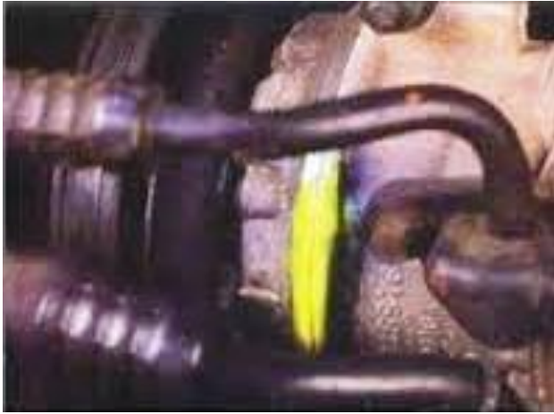
Obr.4-2 Netěsnost příruby kompresoru [32]
